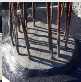
Uszczelnienie styku głowicy pala z uszczelnieniem powierzchni masą bitumiczno-polimerową typu PMBC KÖSTER Deuxan 2K
