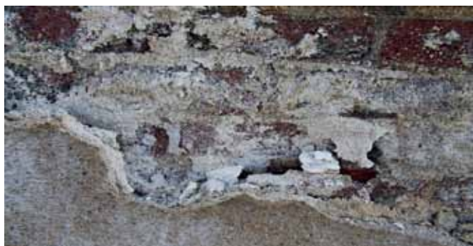
Typowe uszkodzenia spowodowane powstawaniem wykwitów solnych.
