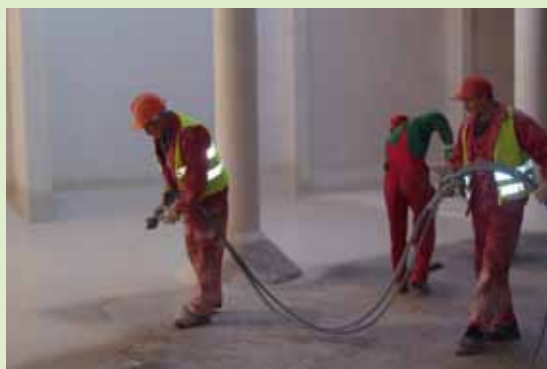
Spremnik pitke vode, Tarnów, Poljska
